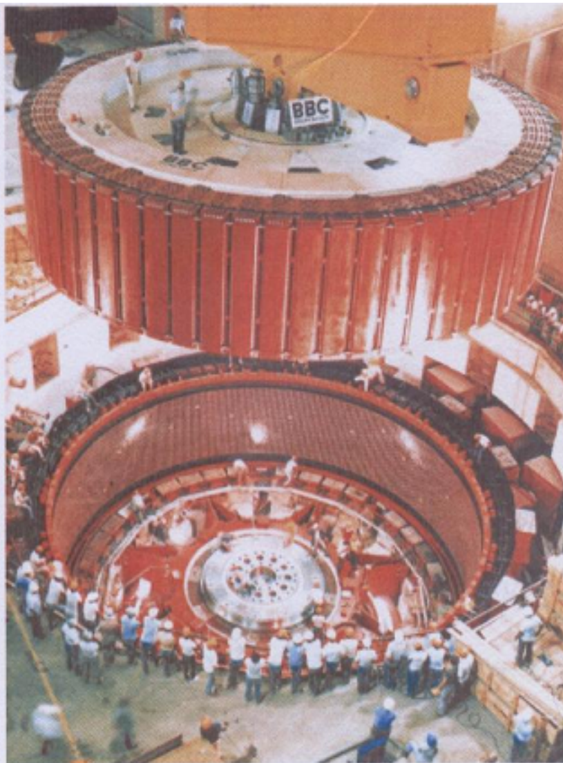
Fig. 33: Hidroalternador sincrónico trifásico de la central de Itaipú de 824 MVA, 90 r.p.m., 60 Hz (Fuente: Revista ABB, nº 1, 1992).
