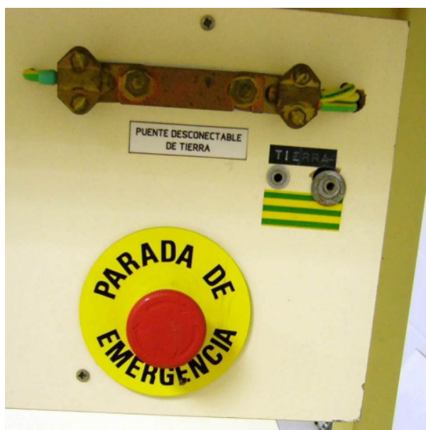
Fig. P0.2: Seta de parada de emergencia y bornes de puesta a tierra de una regleta.
