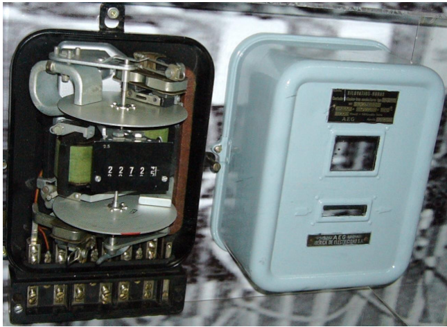
Fig. 2.29: Interior de un contador de energía eléctrica de inducción
