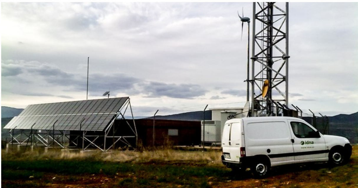
Figura 54. Ejemplo de instalación fotovoltaica y eólica vinculada a una estación TDT en Uceda (Guadalajara, España). https://bit.ly/2AZwlyA
