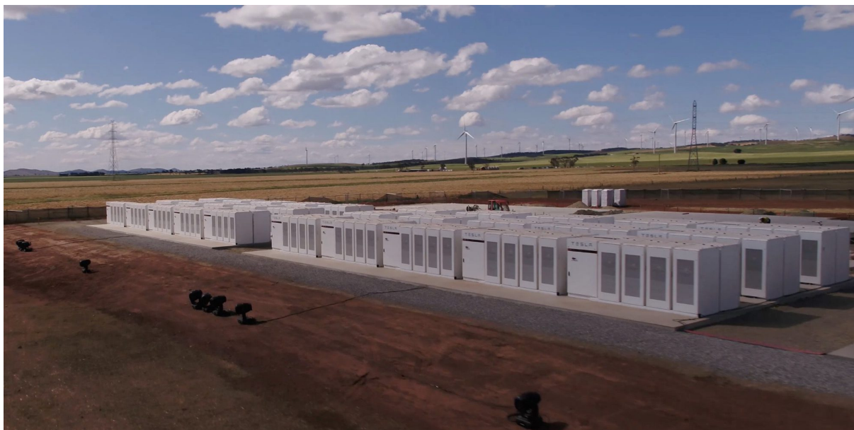
Figura 52. Proyecto PowerPack de Tesla en Hornsdale (Australia). Fuente: electrek http://bit.ly/2DJsw0W
