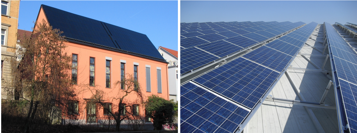
Figura 110. Ejemplos de instalaciones FV en tejado: (izquierda) empleando la propia inclinación del tejado; (derecha) empleando una estructura para dotar a los paneles de un ángulo de inclinación óptimo. Fuente: (izquierda) https://bit.ly/2DgfpFH Licencia de documentación libre GNU; (derecha) https://bit.ly/2CPua11 Licencia CC BY 2.0
