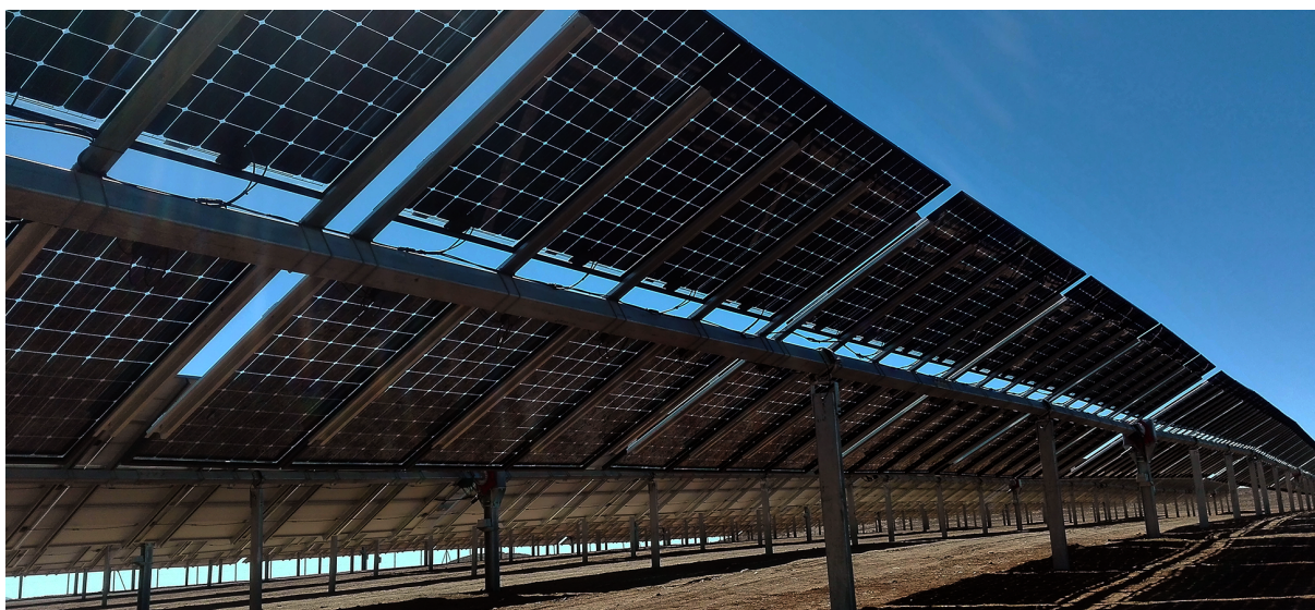
Figura 65. Ejemplo de instalación solar FV con módulos bifaciales. Fuente: Soltec. https://bit.ly/2Kzy6fh
