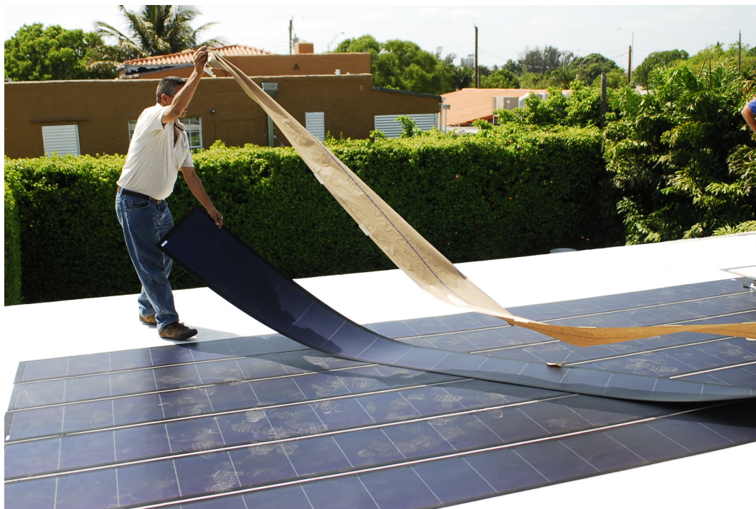
Figura 56. Ejemplo de instalación fotovoltaica con paneles de capa fina. Fuente: Fieldsken Ken Fields (CC BY-SA 3.0). https://bit.ly/2lA2p1W .
