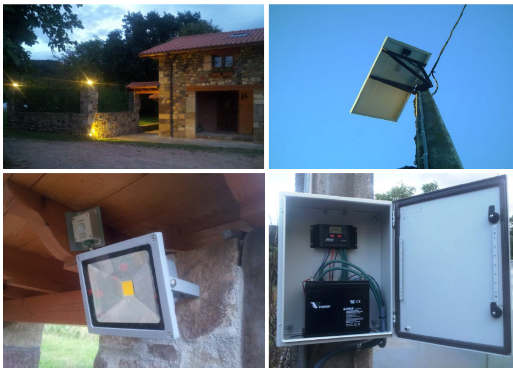
Figura 128. Imágenes del proyecto FV (de parte superior a inferior y de izquierda a derecha): imagen de la vivienda con el sistema FV de iluminación en funcionamiento; detalle del panel FV instalado en poste de hormigón; detalle de foco LED de 20W y detector PIR; detalle de la instalación del regulador de carga y la batería. Fuente: Instalación fotovoltaica aislada programable para alumbrado exterior con detector de presencia (David Lavín) . Licencia: Atribución-NoComercial-SinDerivadas 3.0 España.
