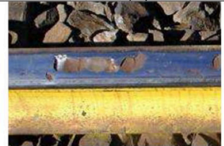
010504 Aplastamiento de la superficie de rodadura muy severo con desprendimientos [40]
